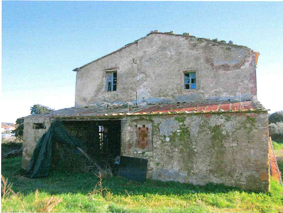
Foto 3: Prospetto ovest – prima del crollo si nota carraia addossata alla facciata ex Chiesa
