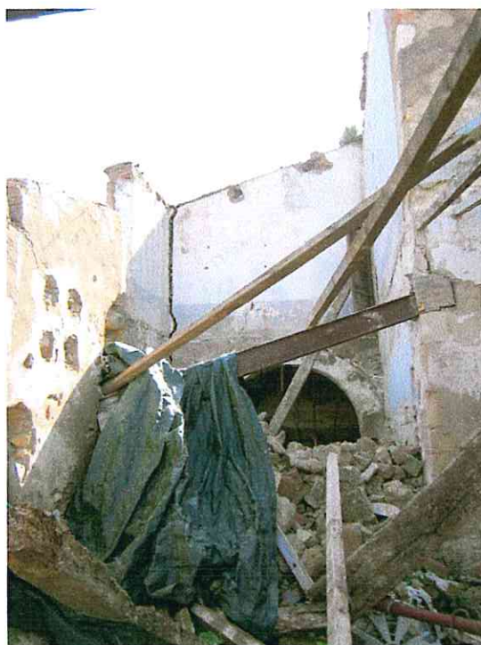
Foto 8: Carraia addossata all'ex Chiesa in parte crollata
