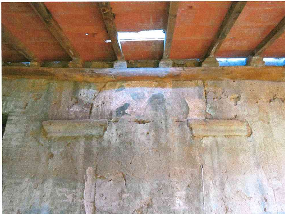
Foto 10: Portale tamponato ex Chiesa con incongruo addossamento della Carraia
