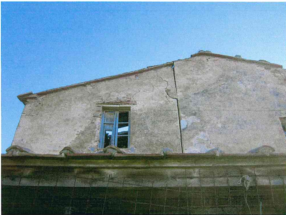
Foto 6: Distacco tra corpo aggiunto e facciata ex Chiesa – prima del crollo
