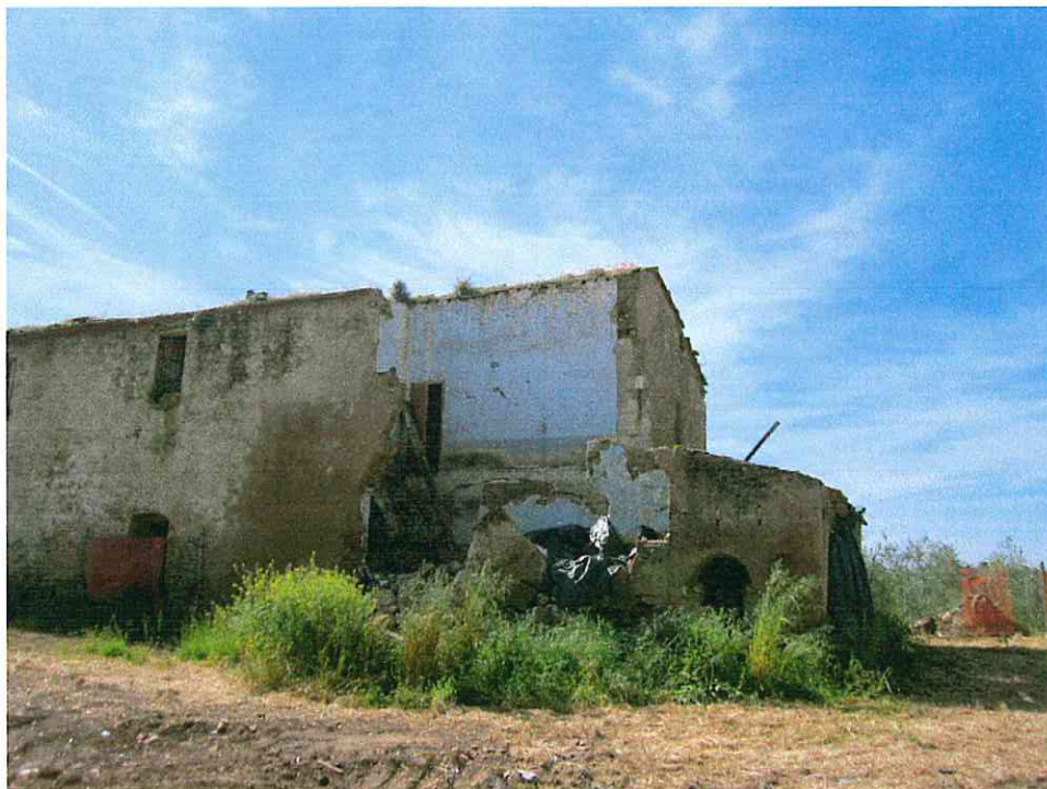
Foto 7: Corpo (superfetazione) addossato all'ex Chiesa in parte crollata
